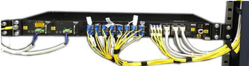
(Roteamento de fibras ópticas internas diretamente)
